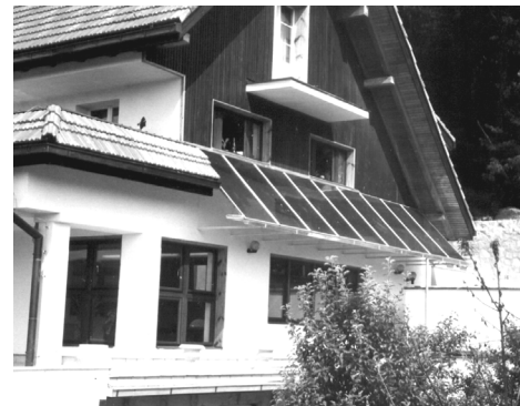
Obr. 4 Kolektory na priečelí budovy
