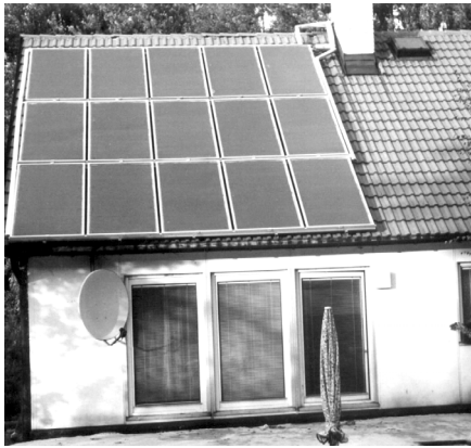
Obr.1 Kolektory na sedlovej streche
